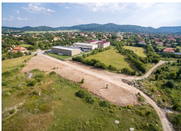
Slika 5. Izgled divljeg odlagališta nakon djelomične sanacije
